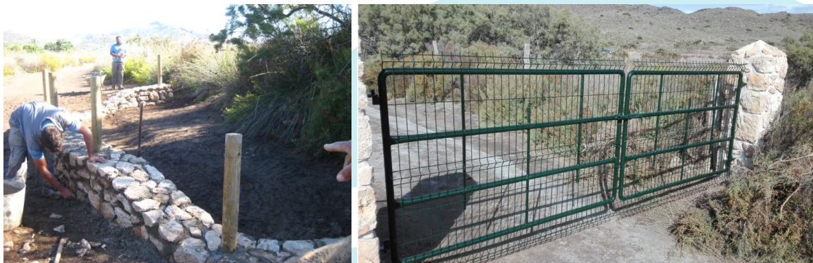
Imágenes 8 y 9. Construcción de balsa para anfibios y sustitución de puerta de acceso a las Salinas.
