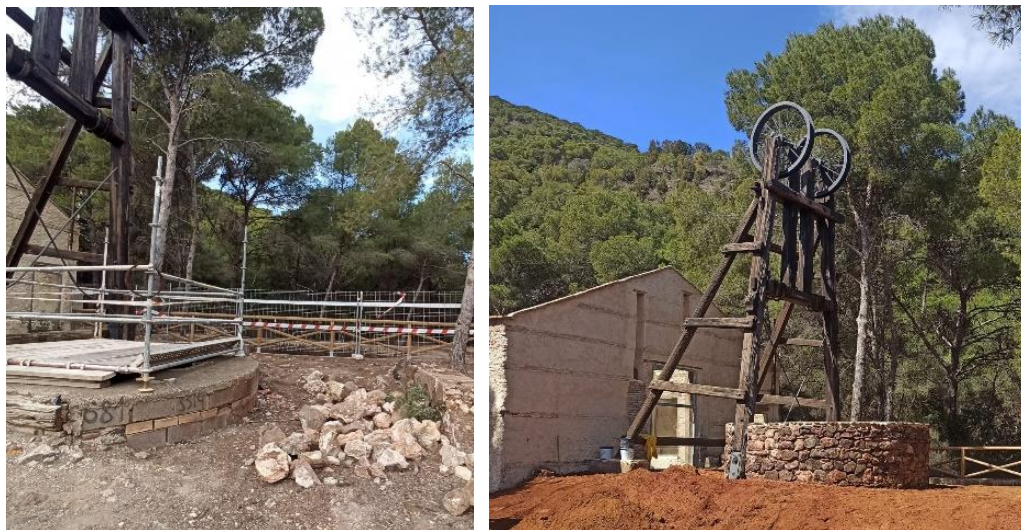
Imágenes 23 y 24. Estado de la protección del pozo antes y después de las obras.
