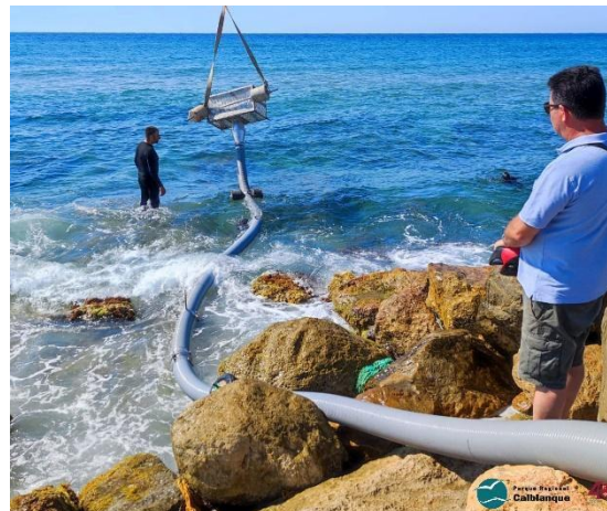
Imagen 11. Instalación del sistema de abastecimiento de agua de mar a las Salinas del Rasall.
