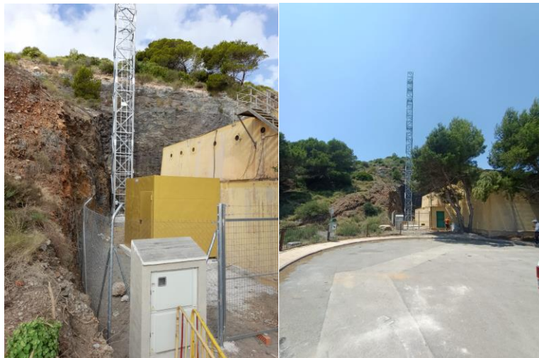
Imágenes 30 y 31. Antena de Telecomunicaciones instalada junto a caseta de telecomunicaciones y el depósito de agua de la urbanización.
