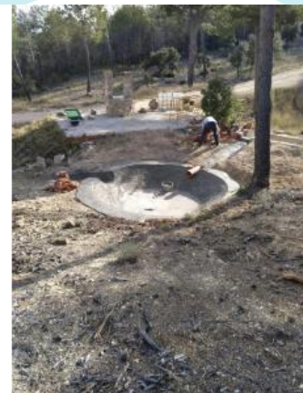
Labores de acondicionamiento y restauración de uno de los aljibes de la Sierra del Carche
