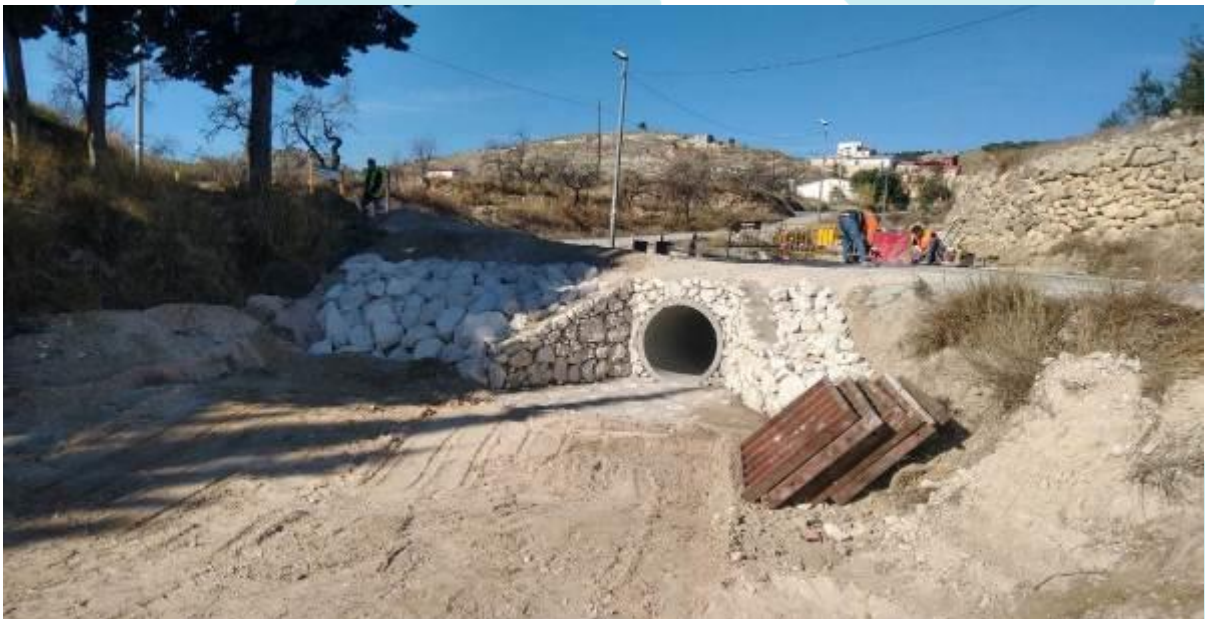
Imágenes: Proceso de construcción de tajea y alcantarilla colectora – Pedanía de la Garapacha.. Fortuna
