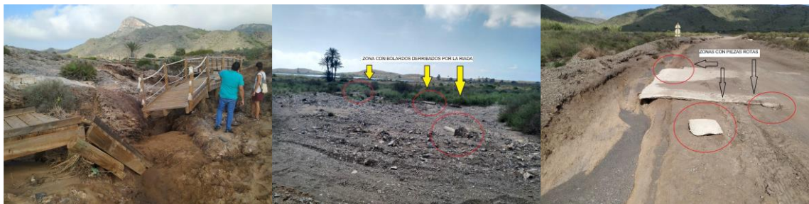
Imagen 28. Estado de las infraestructuras de uso público tras el paso de la DANA.
