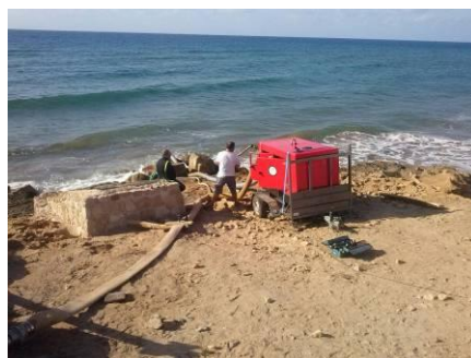
Foto 17 Sistema de bombeo para la captación de agua
