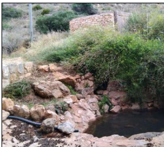
Imagen 34. Depuradora del Centro de Visitantes y cuerpo de agua asociado.
