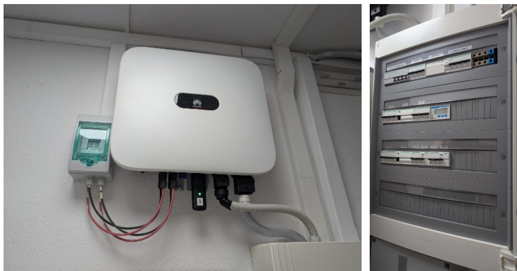
Imagen 18. Registrador de datos de las placas solares y cuadro eléctrico en el Centro de Visitantes.
