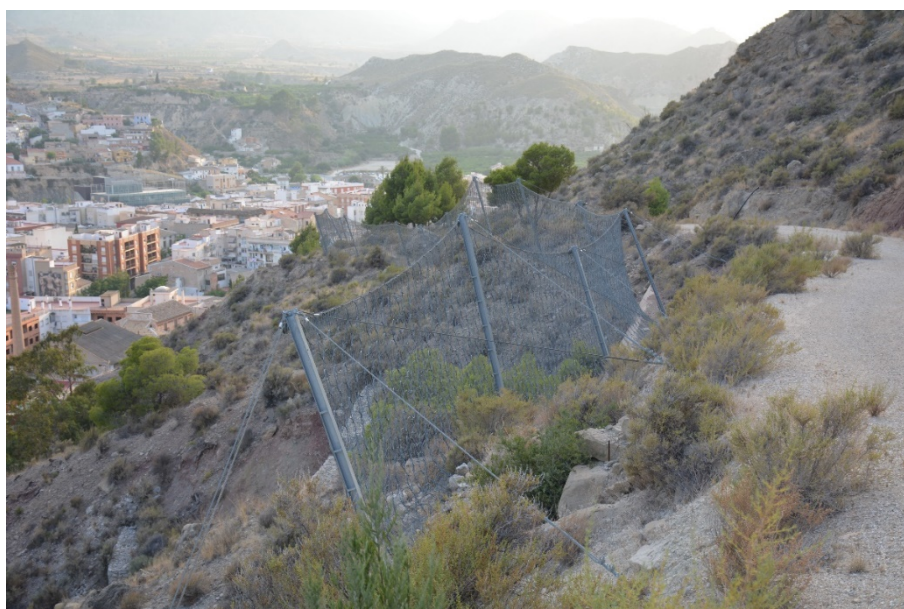
FOTO 8. Sistema de protección instalado en el MUP – 41 (barrera dinámica)
