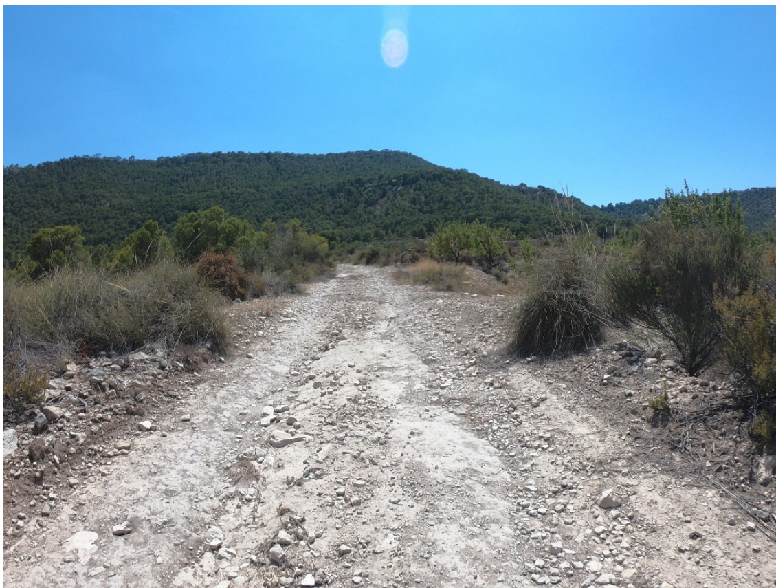
FOTO 12. Tramo de la Pista “OJ-M0065-N2-2” con necesidad de acondicionamiento de la explanada
