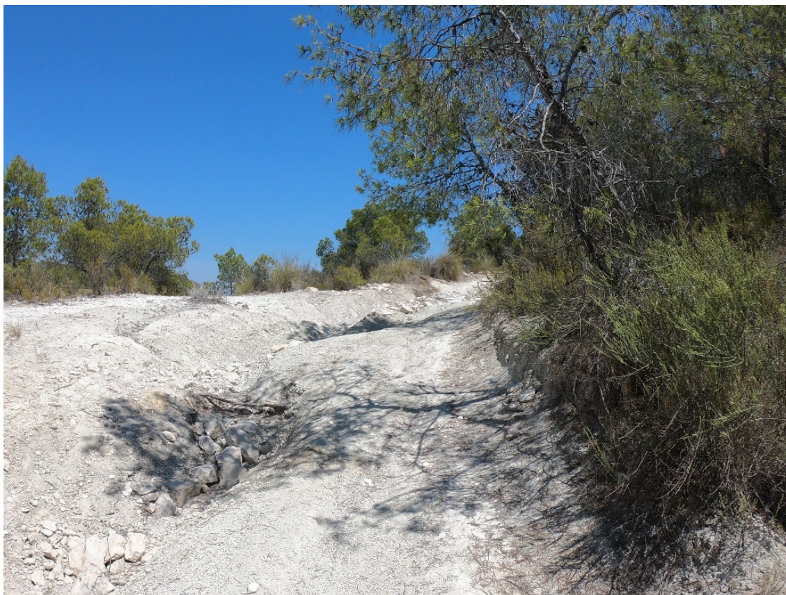
FOTO 11. Tramo de la pista “ OJ-M0065-N2-5” con necesidad de tratamiento prioritario en el drenaje
