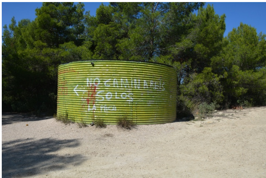
FOTO 11. Depósito contra incendios
