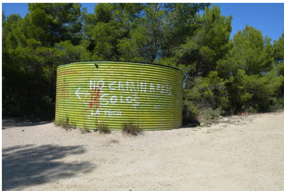
FOTO 7. Depósito contra incendios existente
