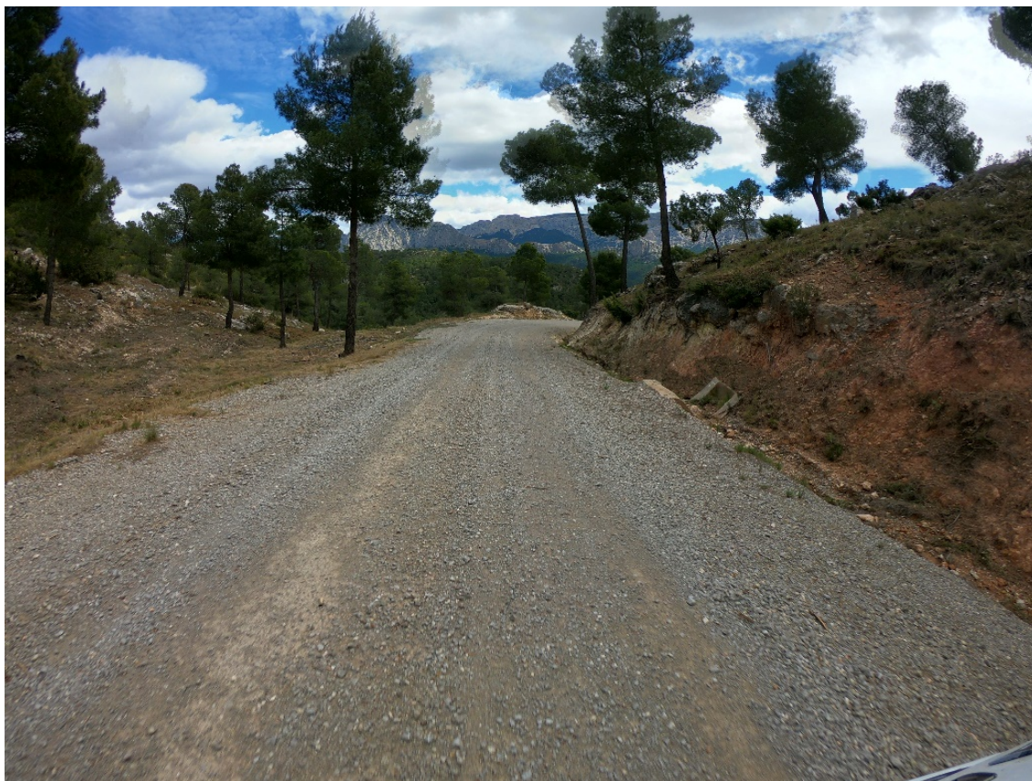
FOTO 7. Tramo de la pista “MU-M0076-N1-1” con necesidad de limpieza de elementos de drenaje.
