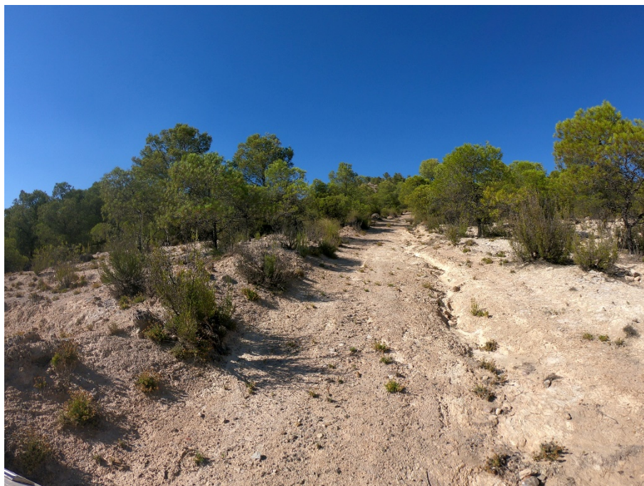
FOTO 12. Tramo de la pista "CI-M0157-N2-1" con necesidad de acondicionamiento de la explanada
