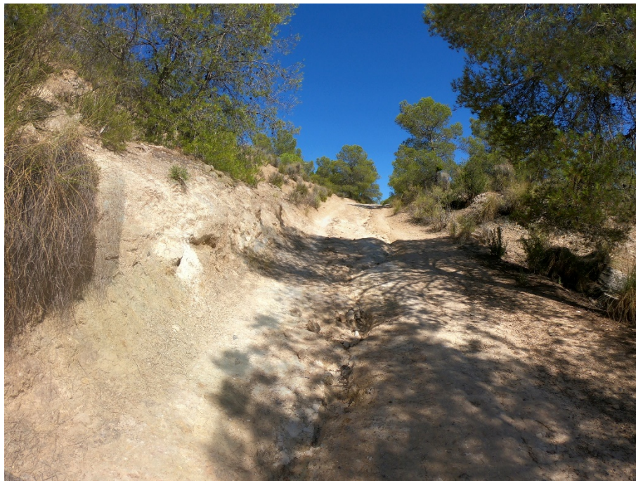
FOTO 11. Tramo de la pista "CI-M0157-N1-2" con necesidad de tratamiento en materia de drenaje
