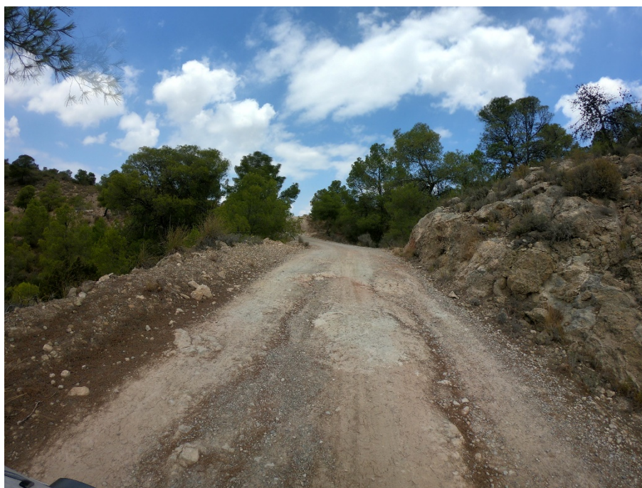
FOTO 12. Tramo de la Pista "CI-M0044-N1-2" con necesidad de acondicionamiento de la explanada
