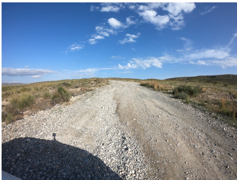
FOTO 9. Necesidad de acondicionamiento de la explanada en la Pista" CI-M0139-N1-1"
