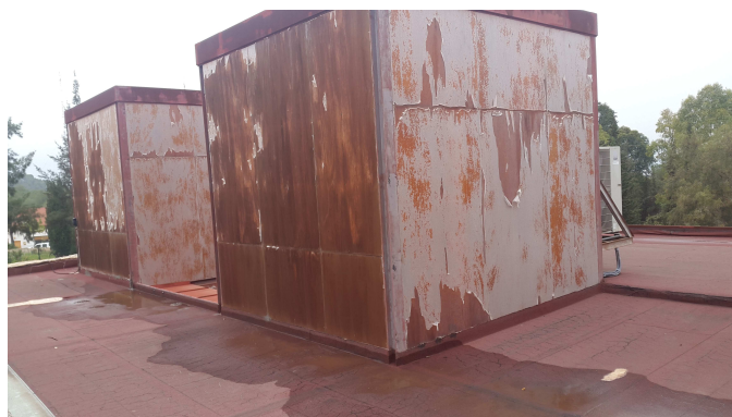
Concentración de humedades en el techo
