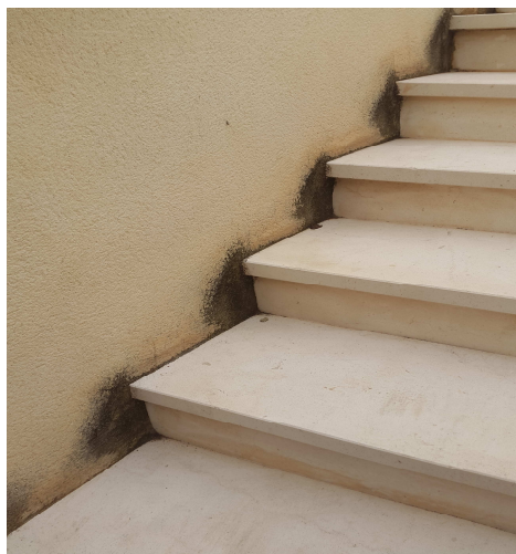
Humedades en escaleras exteriores
