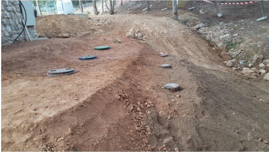
Foto 6: Instalación final del sistema de depuración
