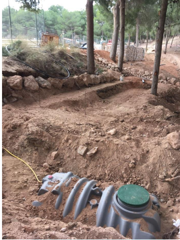
Foto 3: Detalle del depósito de emergencia
