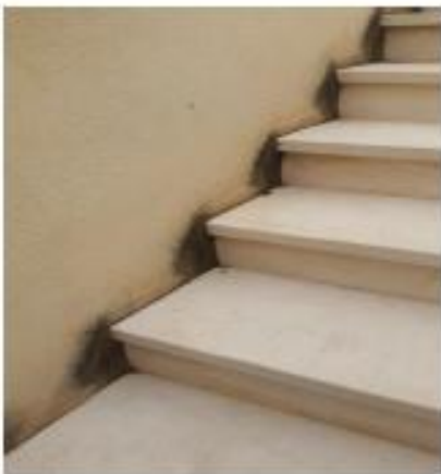
Humedades en escaleras exteriores
