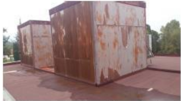
Concentración de humedades en el techo
