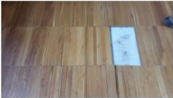
Detalle del estado del suelo
