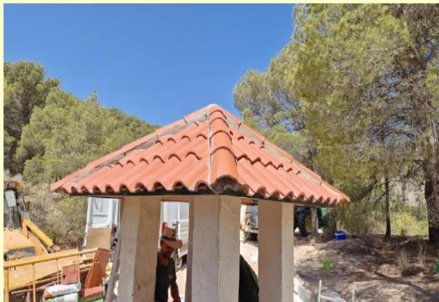
Imagen del estado modificado del aljibe
