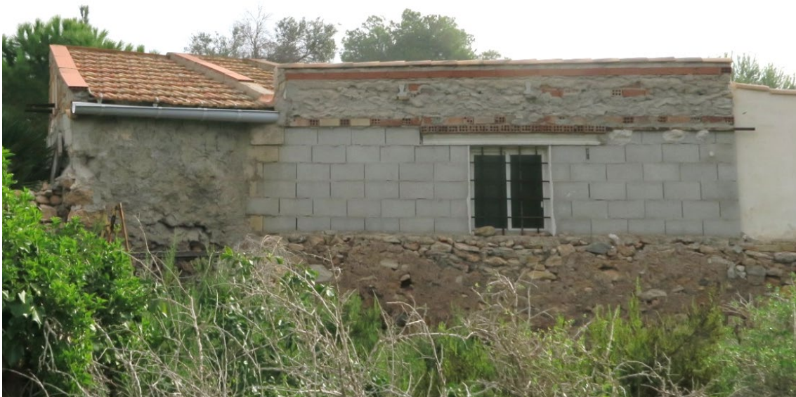
Vivienda J-06. Deficiente construcción de la ampliación realizada.
